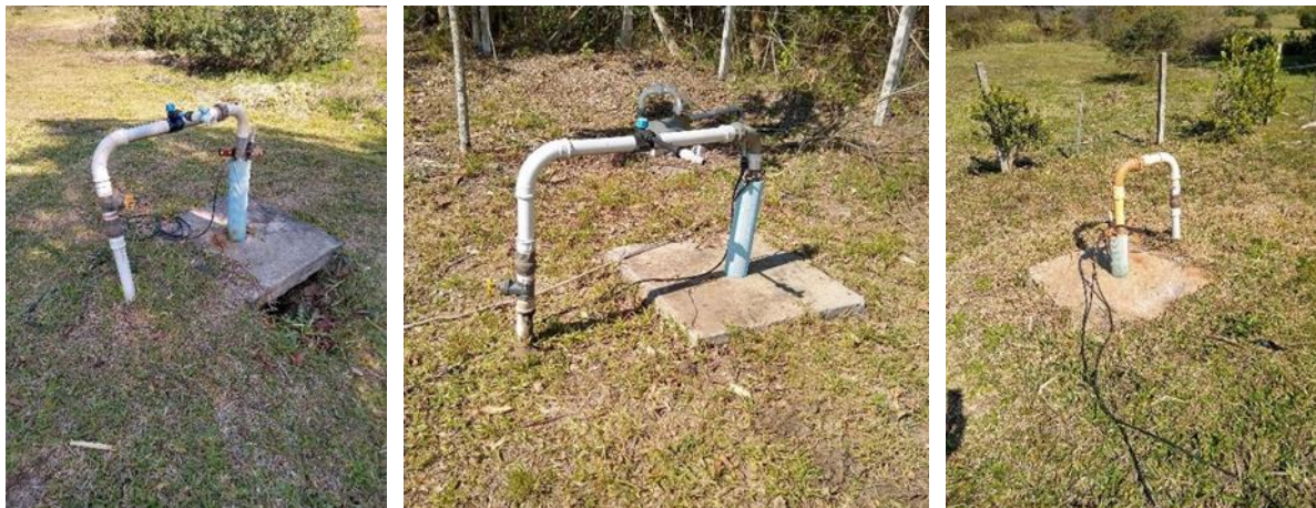
Figura 7 - Poços de captação subterrânea em funcionamento
